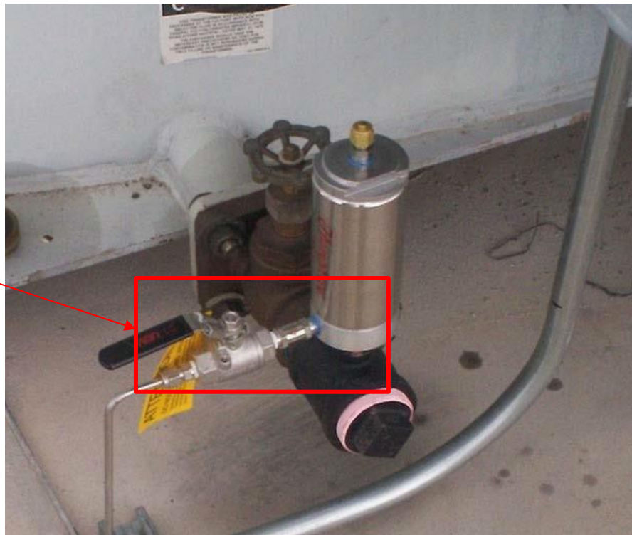
Figura 4: Dispositivo de purga instalado
